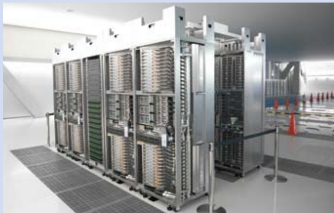
最初に搬入された筐体
